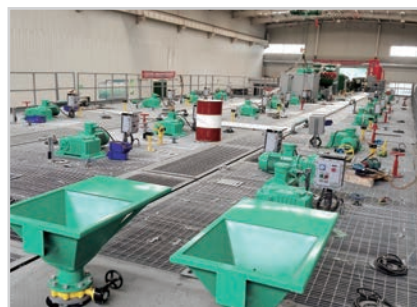
Цех по сборке и заводском испытанию полной системы
