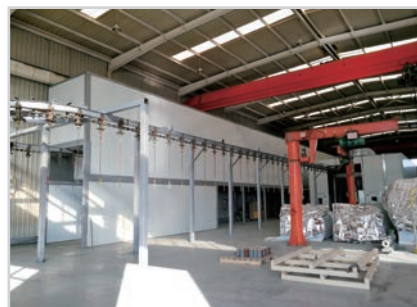
Автоматическая линия по покраске порошком
